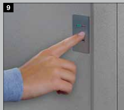
Apertura de puerta mediante huella dactilar; montaje en la hoja de la puerta
